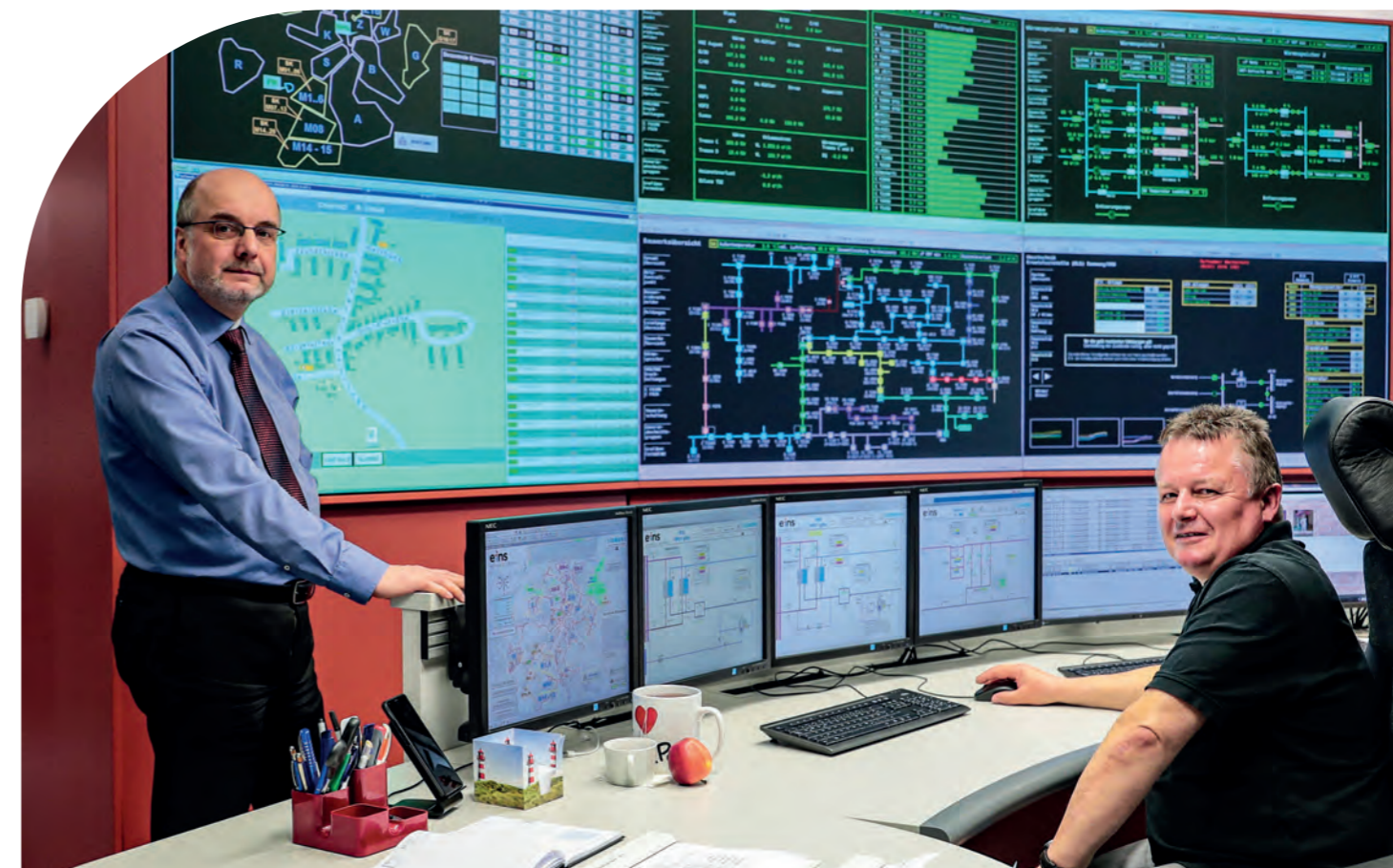
In der Netzleitstelle werden alle Vorgänge in den Strom-, Gas-, Trinkwasser-, Wärme- und Kältenetzen auf großen Monitoren rund um die Uhr überwacht.
